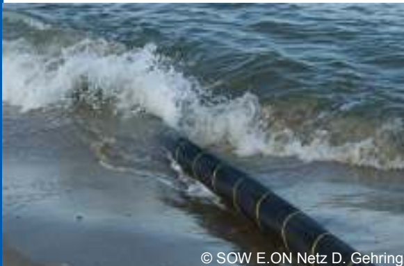
© SOW E.ON Netz D. Gehring
