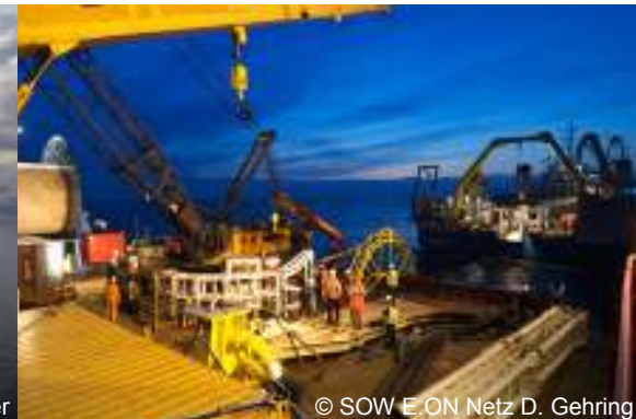
© SOW E.ON Netz D. Gehring
