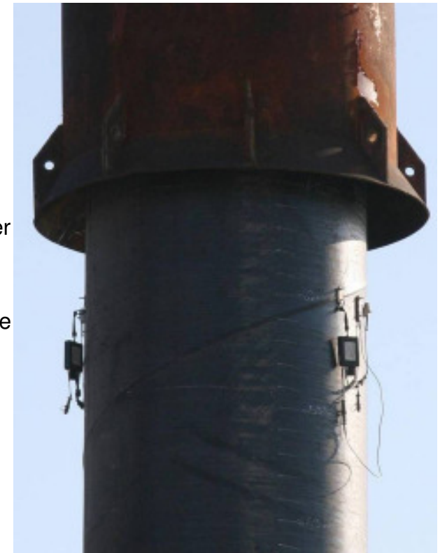
Sensoren am Pfahl (Offshore)
